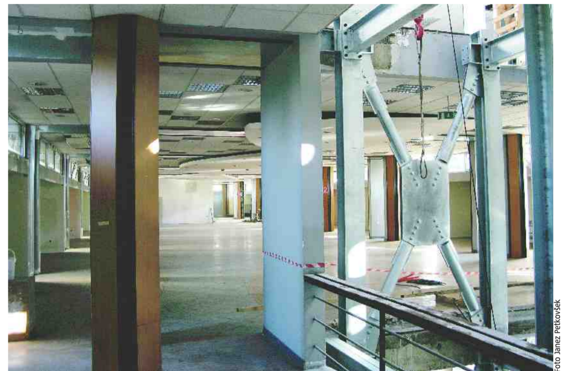
DEL NOTRANJOSTI BODOČE ASTRÉ – Veleblagovnico Astra ob Dunajski cesti, ki je bila včasih eden pomembnejših trgovskih centrov za Bežigradom, v zadnjih dveh letih pa je bolj ali manj prazna, lahko črtamo s seznama ljubljanskih sramot. V pritličju so uredili prostore za plesno šolo Bolero, prenova 4800 kvadratnih metrov neto površine od druge kleti do drugega nadstropja (na fotografiji je viden del novega osrednjega stopnišča z dvigali) pa bo končana še pred koncem leta. Z razsvetljavo bodo ponoči poudarili Severjevo arhitekturo. Ta bo močnejša ob Dunajski cesti, ob Einspielerjevi pa bo zastrta zaradi bližine stanovanjskega bloka. Objekt bo razsvetljen le deli noči, tako da ne bo moteč za sosedje. V njem bo predvidoma delovalo od 10 do 15 najemnikov ali kupcev (prostore jim bodo dokončali po želji), najemnina pa bo znašala od pet evrov v kleti do 20 v pritličju.
